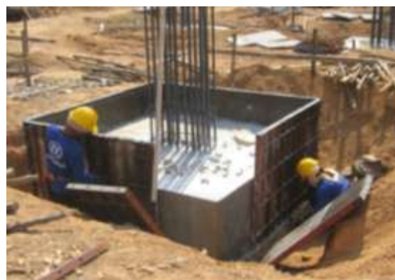
รูปที่ 3.19 แสดงการแกะแบบหล่อคอนกรีตฐานรากและตรวจสอบคอนกรีตว่ามีโพรงอากาศหรือไม่ถ้ามีโพรงอากาศต้องรีบแก้ไข
