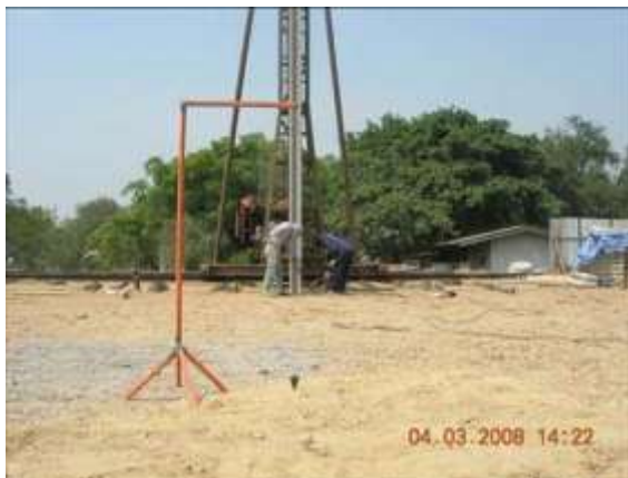
รูปที่ 3.34 แสดงการหาแนวตั้งเสาเข็ม เมื่อแนวตั้งเสาได้ตั้งแล้วจึงสามารถตอกได้
