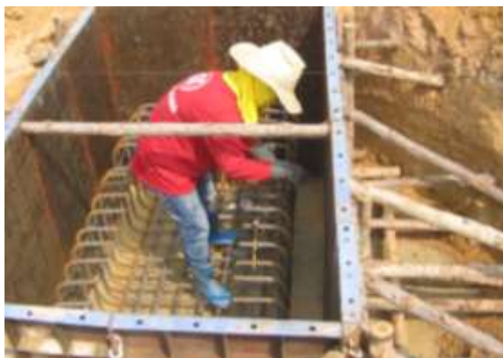
รูปที่ 3.14 แสดงการขุดหลุมฐานรากจะต้องขุดหลุมให้มีขนาดใหญ่กว่าฐานราก เพื่อความสะดวกในการใส่เหล็กเสริมฐานราก
