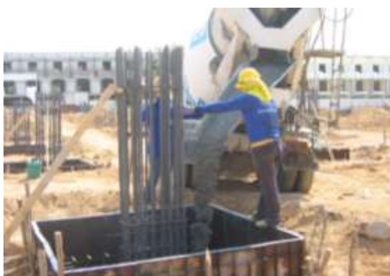
รูปที่ 3.18 แสดงการเทคอนกรีต ก่อนการเทคอนกรีตต้องมั่นใจว่าเสาเข็มยังอยู่ในแนวศูนย์กลาง
