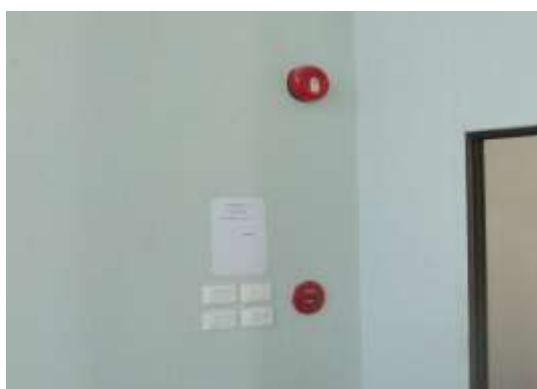
รูปที่ 5.81 การติดตั้งสัญญาณเตือนอัคคีภัย และสวิตช์
