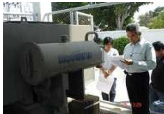
รูปที่ 5.50 การตรวจสอบสภาพหม้อแปลงไฟฟ้าสถานที่ตั้งหม้อแปลง ระยะห่างระหว่างหม้อแปลงกับรั้ว
