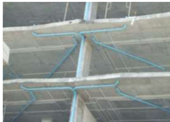
รูปที่ 5.20 ท่อระบายน้ำฝนจากระเบียงที่เตรียมจะเชื่อมต่อจากท่อเมน
