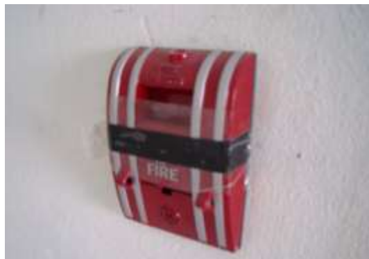
รูปที่ 5.84 อุปกรณ์ควบคุมสัญญาณเตือนอัคคีภัย ต้องมีการทดสอบก่อนการใช้งาน
