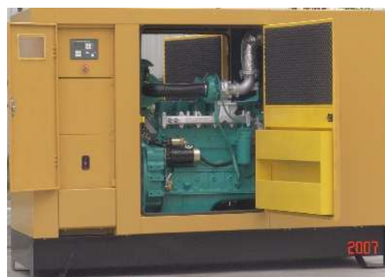
รูปที่ 5.56 เครื่องกำเนิดไฟฟ้า ขนาดใหญ่ ระบายความร้อนด้วยน้ำพร้อมตู้เก็บเสียง ซึ่งสามารถเคลื่อนย้ายได้
