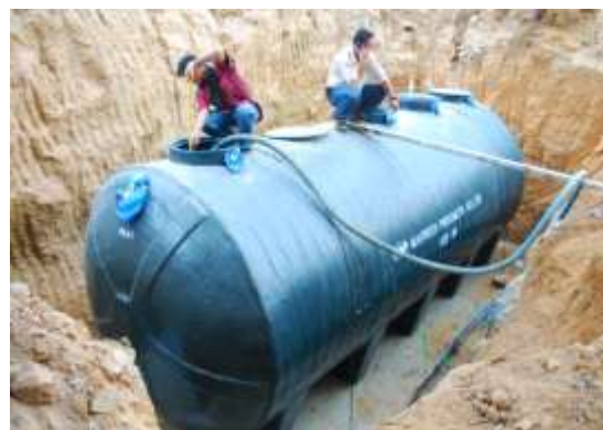
รูปที่ 5.18 การวางถังบำบัดบนคอนกรีตก่อนเชื่อมต่อท่อน้ำไฮโดรคิกเข้าถังบำบัดและส่งออกไปยังท่อบำบัดรวมของท้องถิ่น
