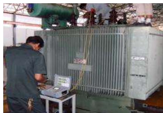
รูปที่ 5.49 การตรวจสอบแรงดันกระแสไฟฟ้าของหม้อแปลงโดยผู้ชำนาญการ
