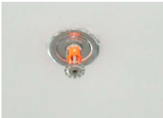
รูปที่ 5.105 การติดตั้งสปริงเกอร์ต้องติดตั้งให้ตรงตำแหน่งที่ระบุไว้ในแบบ
