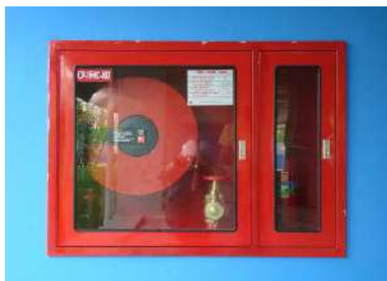
รูปที่ 5.108 การติดตั้งตู้สายฉีดน้ำดับเพลิงต้องตรงตามตำแหน่งและหีบใช้ได้สะดวก
