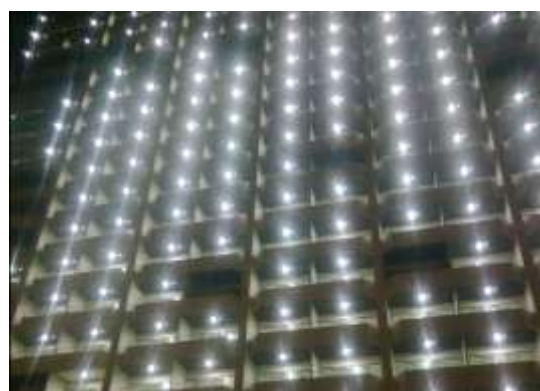
รูปที่ 5.86 เปิดไฟฟ้าแสงสว่างในอาคารทุกดวงจะพบจุดบกพร่องที่ไฟฟ้าไม่ติด
