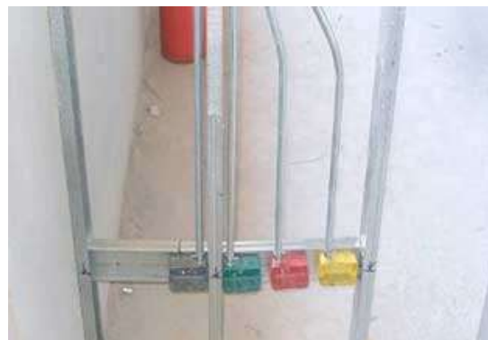
รูปที่ 5.92 ท่อร้อยสายที่ให้รหัสสีสำหรับใช้กับอุปกรณ์ไฟฟ้าสื่อสารต่างๆ
