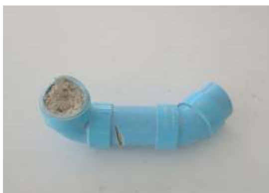
รูปที่ 5.15 ท่อน้ำที่ตัดมา ซึ่งไม่ได้มีการอุดหัวท่อจึงทำให้คอนกรีตไหลลงไปในท่อทำให้ท่อตันและตรวจพบหลังจากอาคารถูกใช้งาน ซึ่งยุ่งยากในการซ่อมแซม
