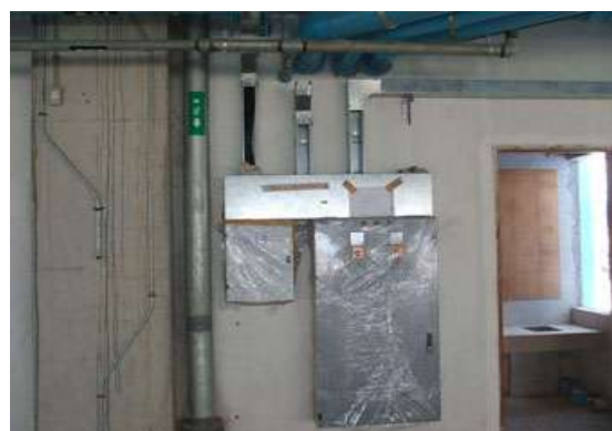
รูปที่ 5.52 แผงเมนบอร์ดควบคุมแต่ละชั้นต้องอยู่บริเวณที่สะดวกต่อการบำรุงรักษา
