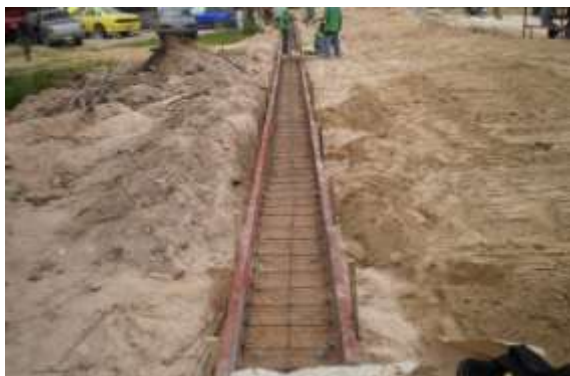
รูปที่ 5.31 การเตรียมแบบและผูกเหล็กกรงระบายน้ำขอบถนนได้ระดับน้ำลงสู่บ่อพัก
