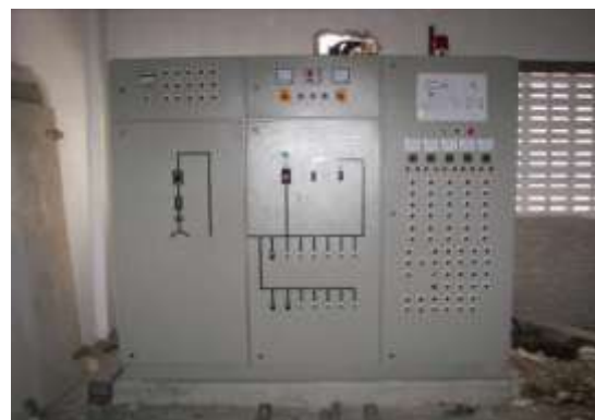
รูปที่ 5.54 เนื่องจากตู้ MDB มีสายไฟจำนวนมากและมีกระแสไฟแรงสูง หากติดตั้งภายในอาคารต้องมีห้องเฉพาะและต้องดูแลรักษาให้เป็นระเบียบมีที่ระบายอากาศ
