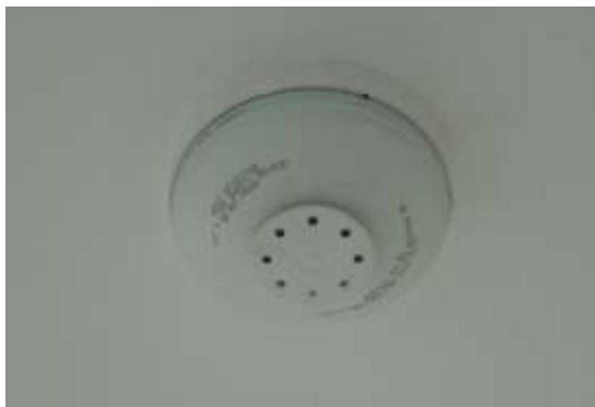
รูปที่ 5.83 เครื่องตรวจจับควัน (Smoke Alarm) ติดตั้งบนเพดาน ต้องมีการทดสอบรมด้วยควันไฟ
