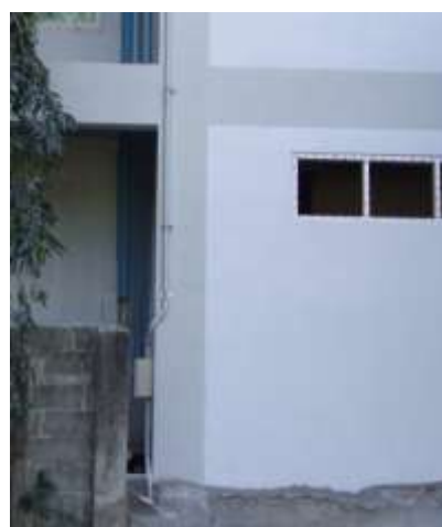
รูปที่ 5.112 การใส่ฉนวนหุ้มสายและยึดติดกับตัวอาคารต้องให้มีความมั่นคง
