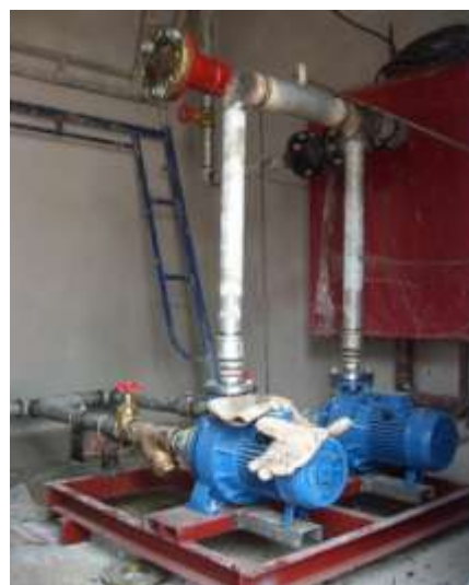
รูปที่ 5.6 ปั๊มน้ำจากบ่อสำรองน้ำใต้ดินไปยัง ถังสำรองน้ำบนดาดฟ้า
