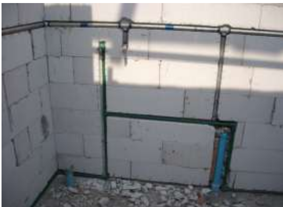
รูปที่ 5.3 การเดินท่อน้ำส่งในผนัง ต้องใช้ท่อ ให้ถูกประเภทตามที่ระบุไว้ในแบบ
