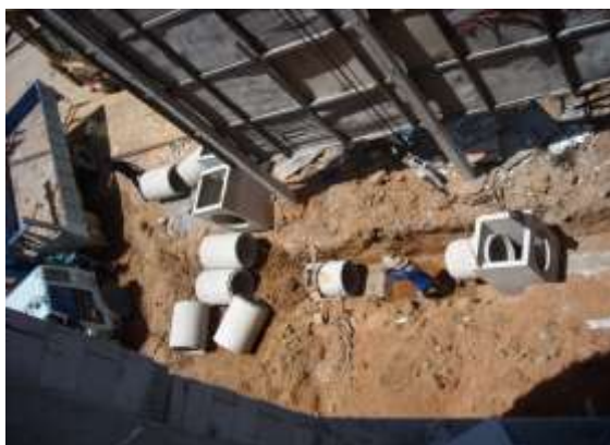
รูปที่ 5.27 การวางท่อและบ่อพักให้ได้ระดับและถูกตำแหน่งบนคอนกรีตลีน
