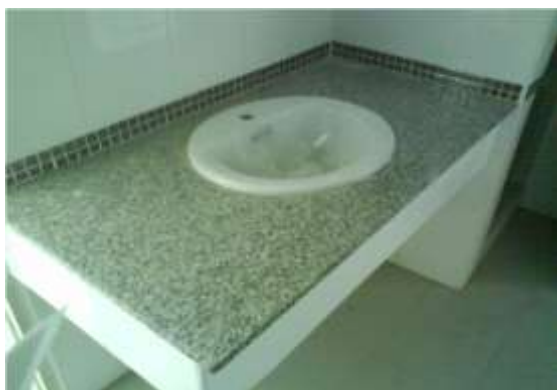
รูปที่ 5.33 การติดตั้งอ่างล้างหน้าประเภทฝังบนแผ่นหินแกรนิต
