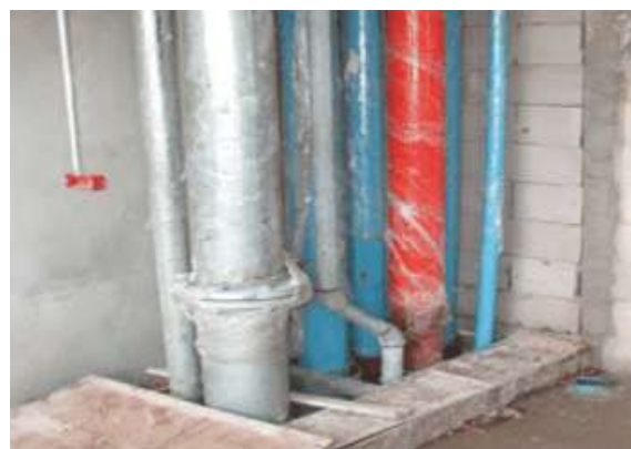
รูปที่ 5.10 การจัดท่อใน Riser หรือช่องเปิดสีแดงจะเป็นท่อดับเพลิง สีบรอนซ์จะเป็นท่อจ่ายน้ำประปาที่มีแรงดันสูง
