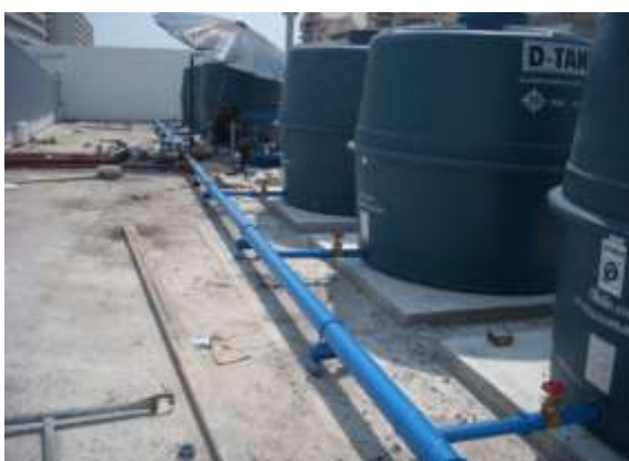
รูปที่ 5.7 ถังน้ำสำรองบนดาดฟ้า
