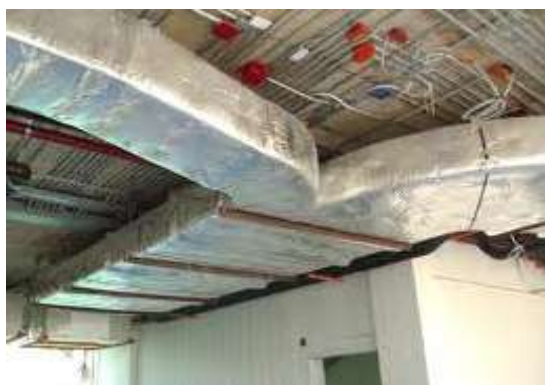
รูปที่ 5.103 การติดตั้งท่อดักแอร์ ในระบบแอร์ขนาดใหญ่ ต้องตรวจสอบการหุ้มฉนวนให้ถูกต้องตามแบบ
