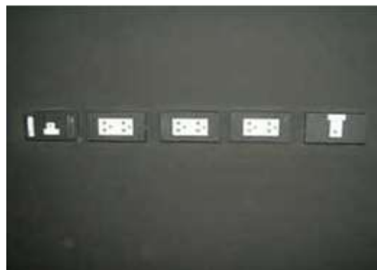
รูปที่ 5.80 การติดตั้งอุปกรณ์ระบบที่ผนัง ยิปซัมฉาบเรียบทาสี
