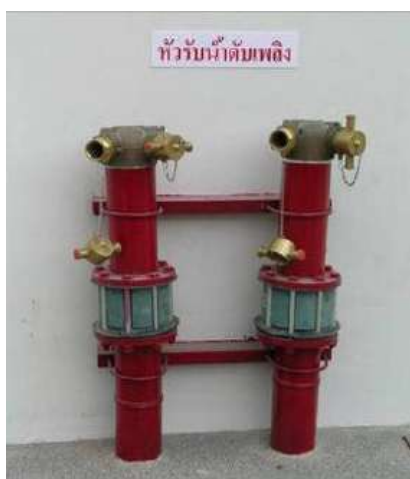
รูปที่ 5.107 หัวรับน้ำดับเพลิงต้องติดตั้งตามที่ระบุไว้ในแบบ
