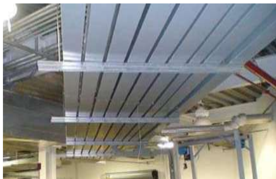
รูปที่ 5.71 การติดตั้งรางเดินสาย (Wireways) ในแนวนอนใต้หลังคาหรือใต้ท้องพื้น
