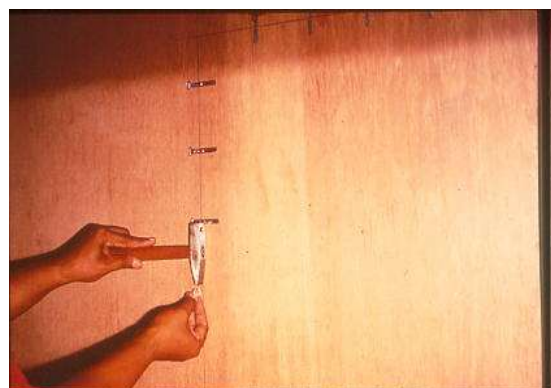
รูปที่ 5.60 การหาแนวสายไฟฟ้าและติดตั้งเข็มขัดรัดสายให้ห่างเท่ากันเพื่อความสวยงาม
