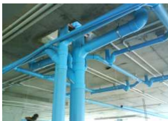
รูปที่ 5.16 ท่อโสโครก ท่อใหญ่จะเป็นท่อจากโถส้วมและโถปัสสาวะ ท่อเล็กจะเป็นท่อน้ำทิ้ง ซึ่งต้องแยกออกจากกันเพื่อป้องกันกลิ่นจากท่อส้วมเข้ามาในระบบน้ำทิ้ง
