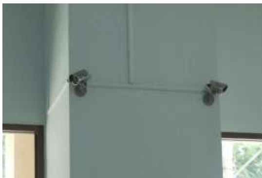
รูปที่ 5.89 กล้องวงจรปิดภายในอาคาร
