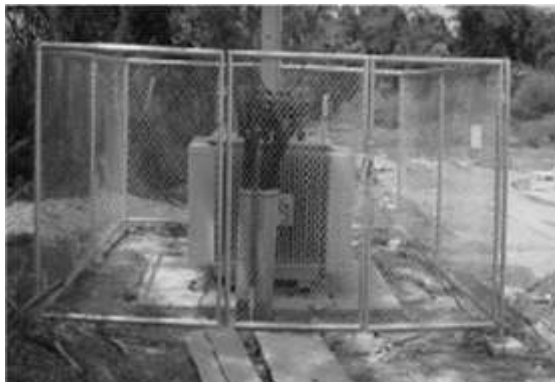
รูปที่ 5.48 การติดตั้งหม้อแปลงไฟฟ้าในระดับพื้นดินต้องมีรั้วป้องกันในระยะปลอดภัย
