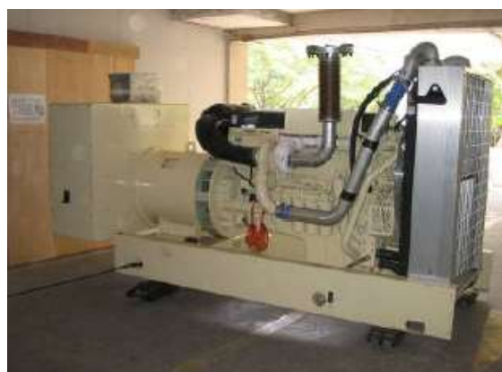
รูปที่ 5.58 แสดงการติดตั้งเครื่องกำเนิดไฟฟ้า ภายในอาคารที่มีการเปิดพื้นที่โล่ง
