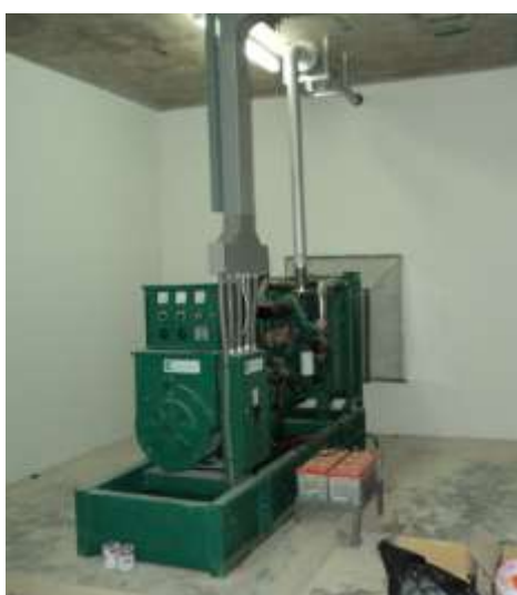
รูปที่ 5.57 ห้องติดตั้งเครื่องกำเนิดไฟฟ้ามีระบบระบายท่อไอเสียและระบบระบายความร้อนจากเครื่องพร้อมมีผนังเก็บเสียง
