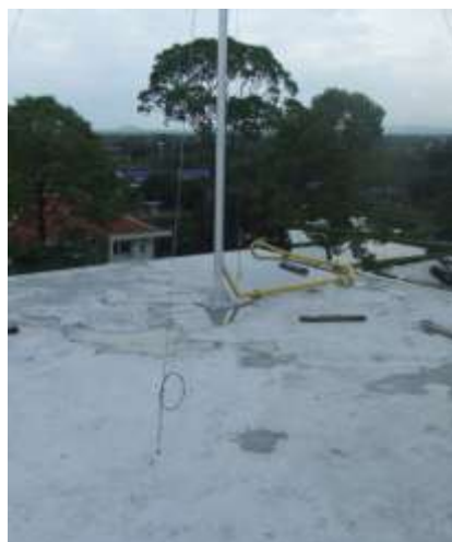
รูปที่ 5.114 สายล่อฟ้าต้องมีใช้สลิงยึดให้มั่นคง เพื่อป้องกันมิให้ตัวเสาล้ม
