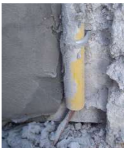
รูปที่ 5.111 การเชื่อมต่อสายทองแดงกับแท่ง (Ground Loop) เพื่อส่งกระแสไฟฟ้าลงดิน
