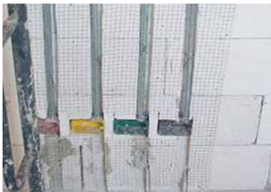
รูปที่ 5.73 การติดตั้งท่อร้อยสายไฟฟ้าแบบฝังผนังก่อนฉาบ
