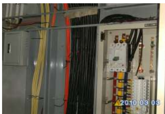
รูปที่ 5.53 การจัดเรียงสายไฟต้องจัดให้อยู่ในสภาพเรียบร้อยไม่พันกันจนไม่เป็นระเบียบ เพราะอาจจะเกิดกระแสไฟฟ้ารั่วได้
