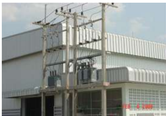
รูปที่ 5.45 หม้อแปลงไฟฟ้าที่ติดตั้งอยู่ในที่โล่ง
