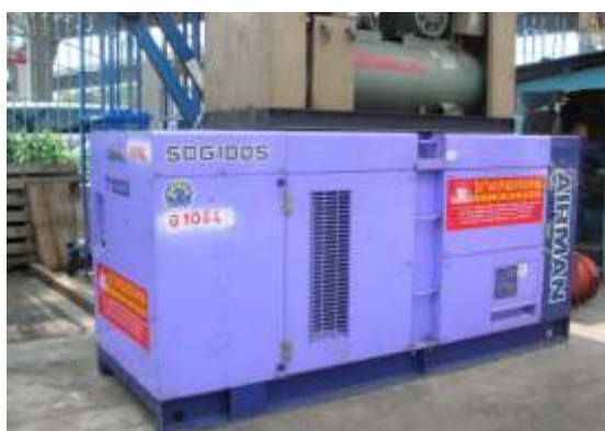
รูปที่ 5.55 เครื่องกำเนิดไฟฟ้าภายในอาคาร
